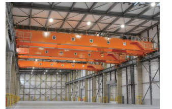
横浜重量物梱包センター 館内LED
